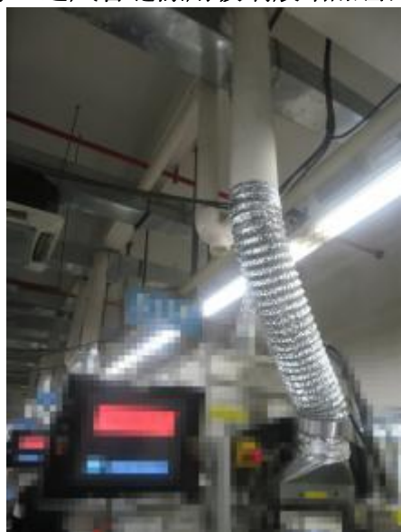
压模废气收集管道
