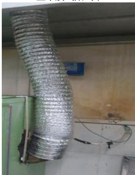
烘烤废气收集管道
