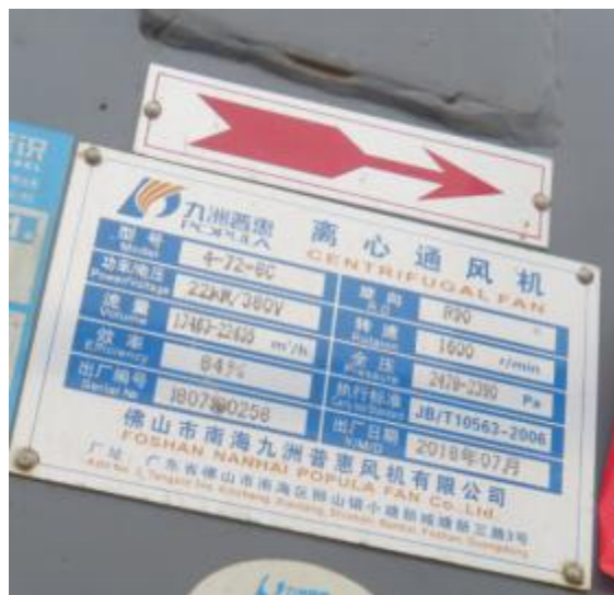
E栋1#处理系统铭牌
