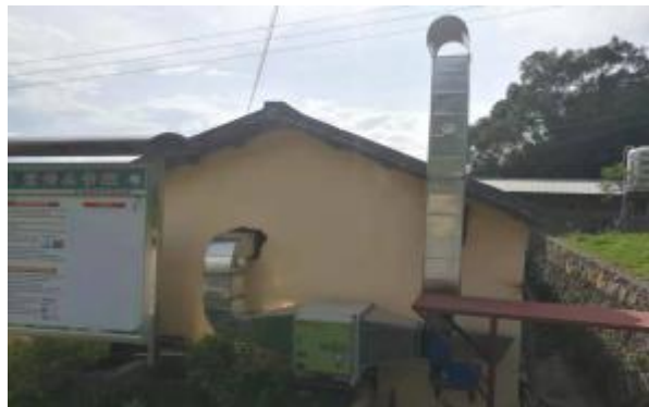
厨房油烟排放口
