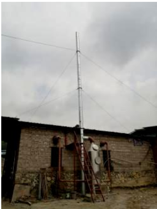
柴油发电机排放口
